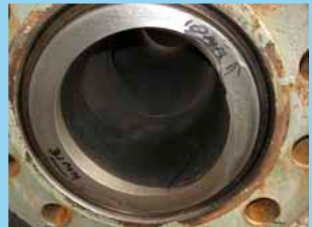
Corrosie/erosie in flowleiding. Ook met schoon en droog gas kan de integriteit van een leiding in gevaar komen (foto SodM)
