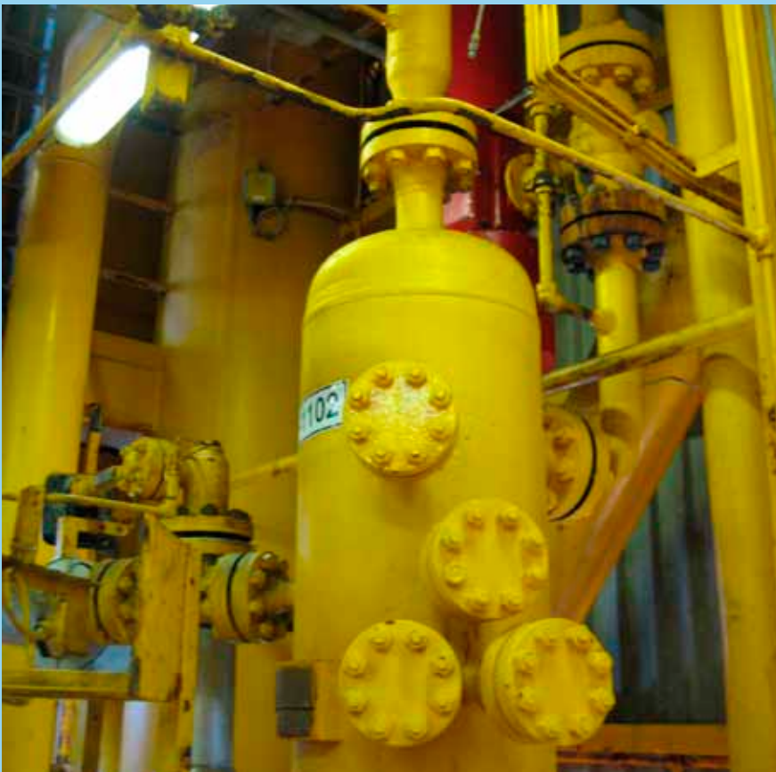
De ventleiding na deze testseparator scheurde open tijdens het op druk brengen van het systeem (foto SodM)
