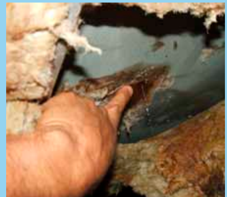
Interne corrosie van een lagedruk productieseparator (foto SodM)
