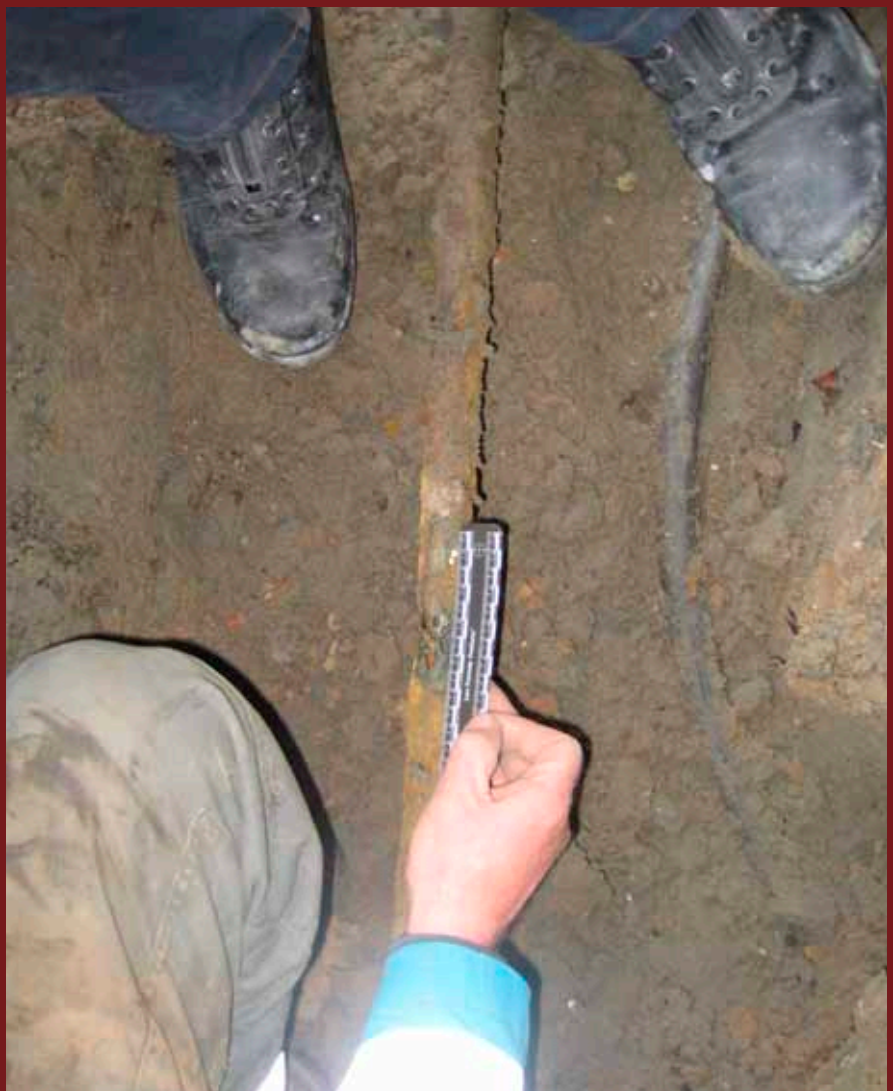
Gecorrodeerde aansluitleiding in de wijk 't Duifje in Arnhem (foto SodM)
