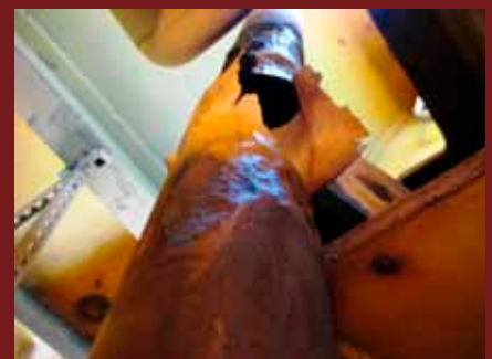
Gescheurde ventleiding door externe corrosie (foto SodM)
