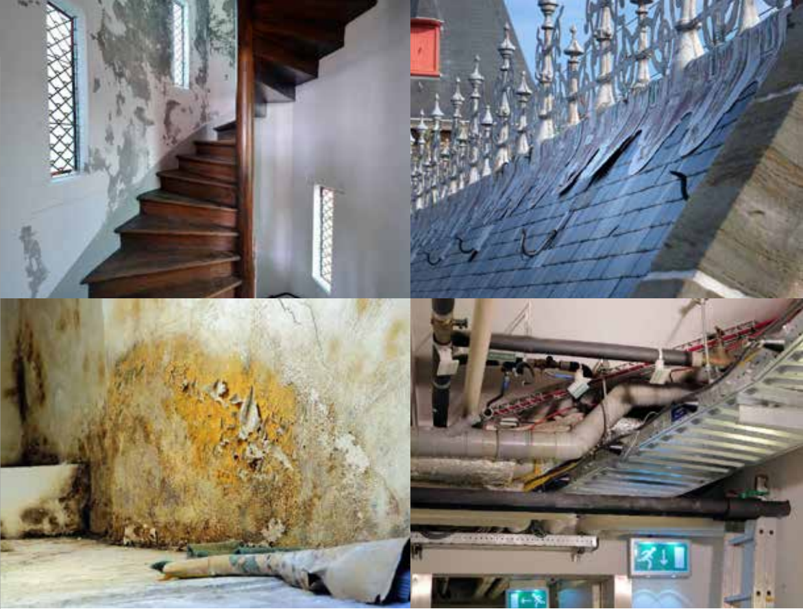
Afbladderende verf, loslatende dakdelen, schimmelvorming en een wirwar aan oude leidingen.
