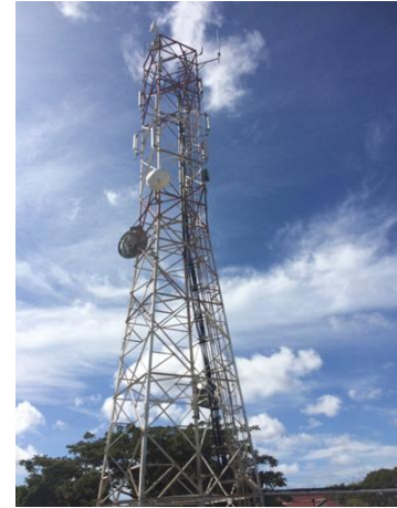
FIGUUR 1: Mast op St Eustatius
