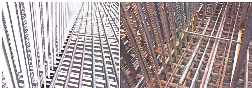
Figuur 23 3D-tekening en foto van een aansluiting van wandwapening op de vloerwapening ( Bron: OpenIJ ).
