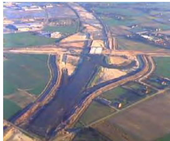
Figuur 4.15 A58 omlegging Etten-Leur, knooppunt Vosdonk. (bron: beeldbank RWS, ID171915, 26 januari 1998, Bart van Eyck).
