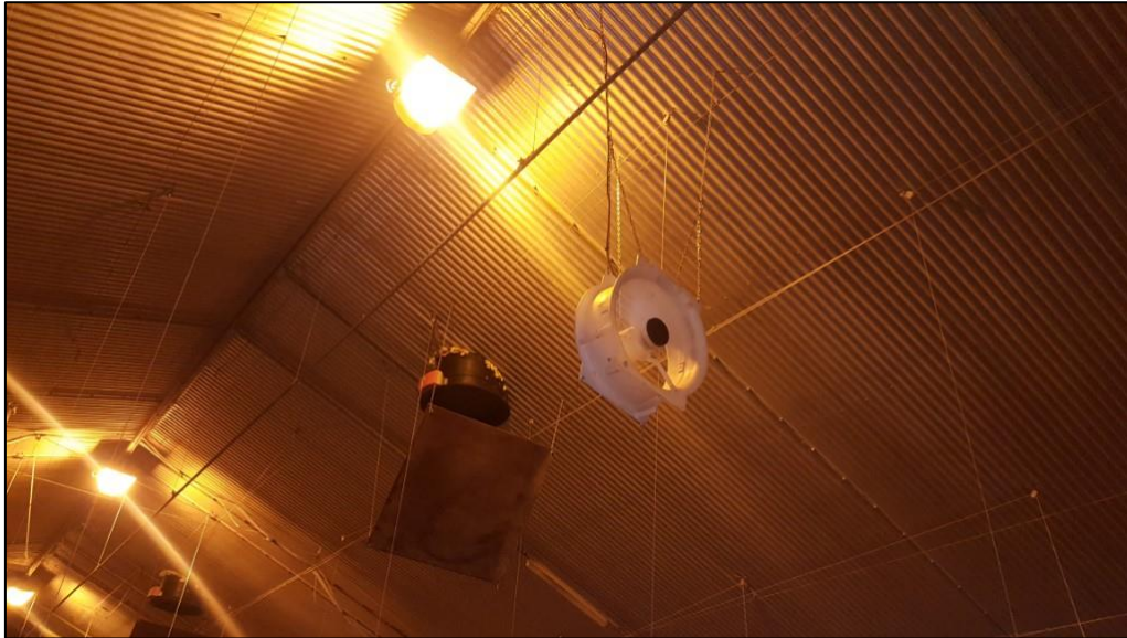
Eén van de zes witte steunventilatoren (t.b.v. verdeling lucht uit warmtewisselaar)
