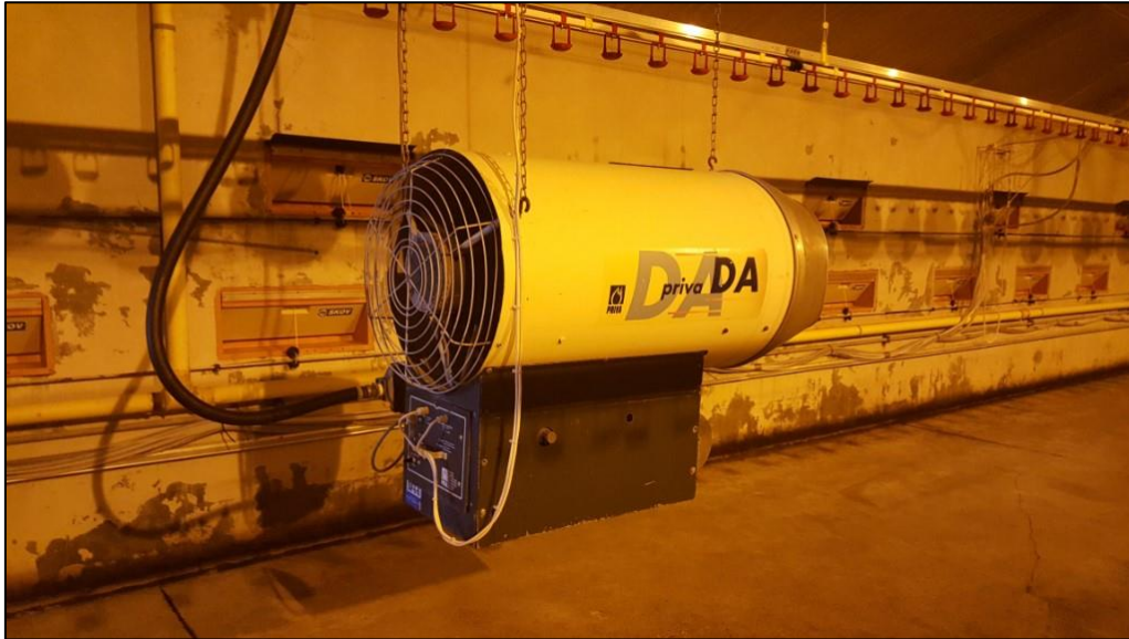
Eén van de vier propaanheaters per stal
