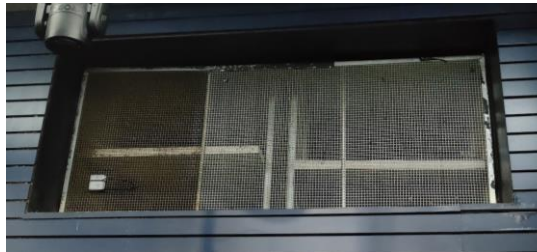
Figuur 10: Afzuigrooster in de zaal na schoonmaak en zonder plaat aan de rechter helft.
