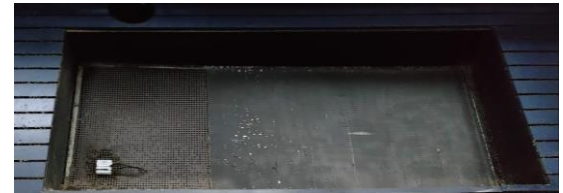
Figuur 9: Vervuild en deels afgeblind afzuigrooster zaal.
