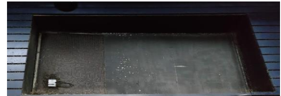
Figuur 9: Vervuild en deels afgeblind afzuigrooster zaal.
