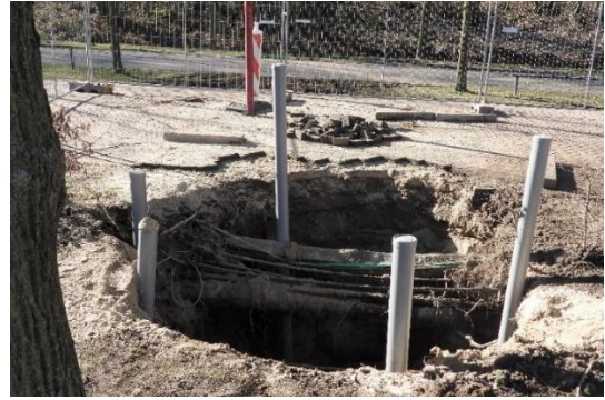
Figuur 35. Ontwikkeling van een sinkhole na ruim een week met blootlegging van leidingen.
