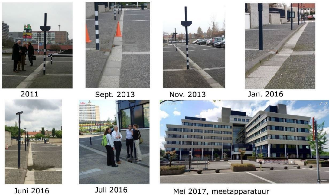
Figuur 31. Lokale verzakkingen op een locatie naast het DSM-kantoor over de jaren heen.
