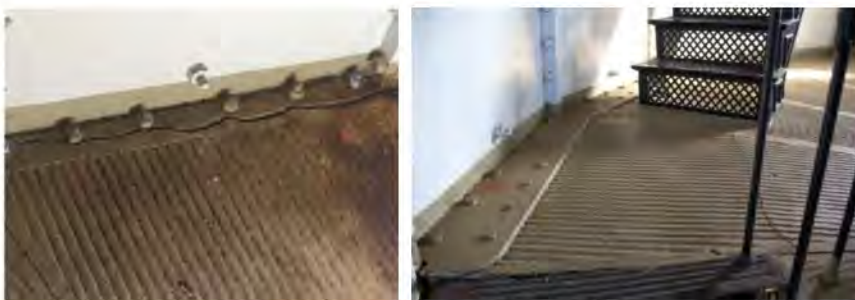
Figuur D 7 Voorbeelden van scheuren in de vloer (foto links uit [3], rechts uit [8]).
