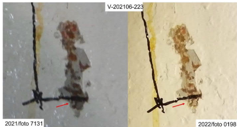
Figuur 2.1: Schade V-202106-223; foto van nulopname (links) en van drone-inspectie (rechts)
