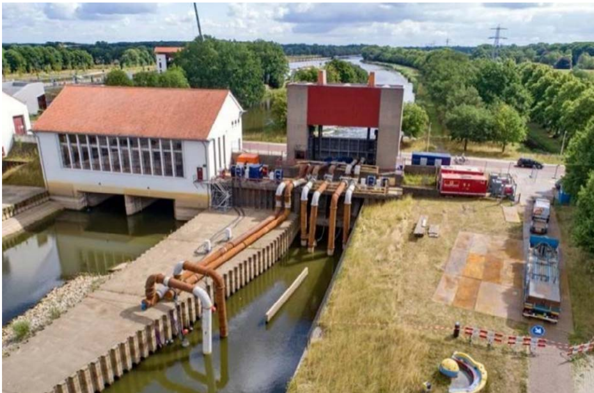
Tijdelijke pompinstallatie bij sluis Eefde.
