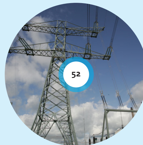
Beter Benutten Bestaande 380 kV Maasbracht-Eindhoven
