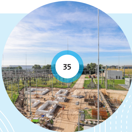
Verzwarend elektriciteitsnet Noord-Brabant (Moerdijk en Geertruidenberg)
