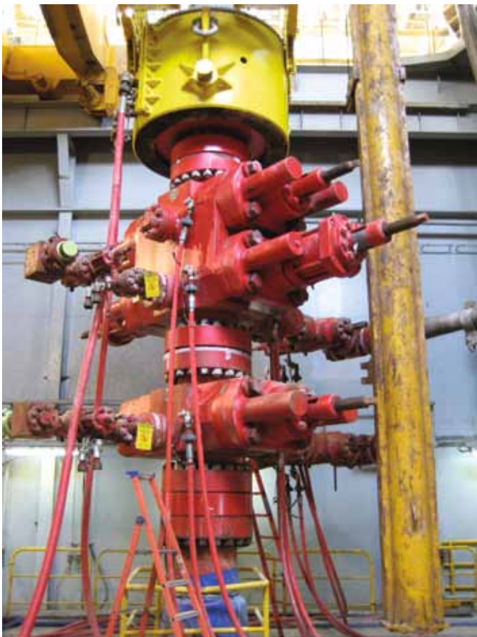
BOP op een mobiele boorinstallatie offshore (foto SodM)
