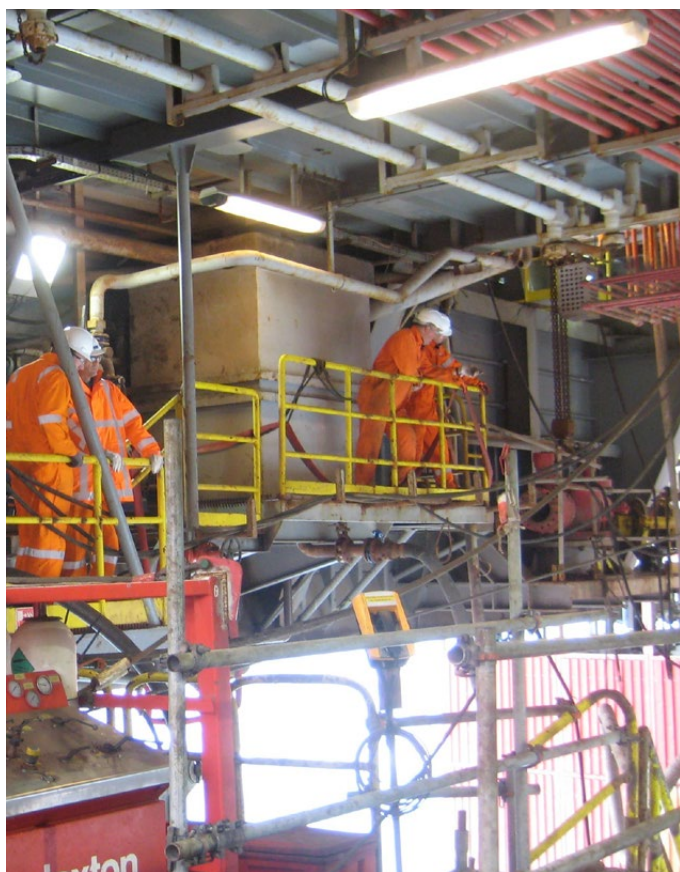
De rechthoekige triptank, geplaatst op een niet vloeiend dichte vloer, gesitueerd boven zee (foto SodM)
