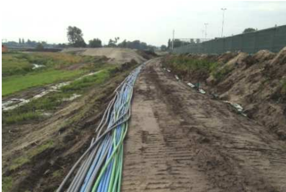
Figuur 6 Problematiek van kabels en leidingen bij schermplaatsing kunnen tot hogere kosten leiden. Is dit een legitieme reden om geen scherm te plaatsen en begrijpen de omwonenden dat?
