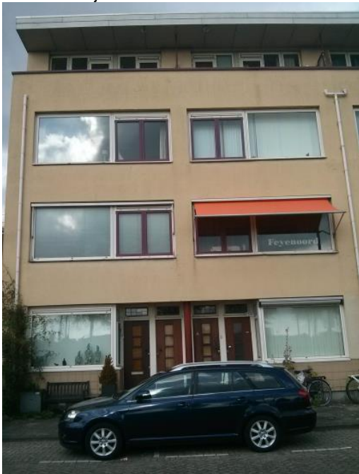
Foto 10 Zichtbaar zijn vervuiling raamdorpels van raamdorpels en waterslagen
