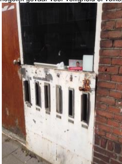
Foto 8 Deze brievenbussen en portiek verdienen een onderhoudsbeurt, maar is nog niet slecht genoeg om te handhaven op de Woningwet.
