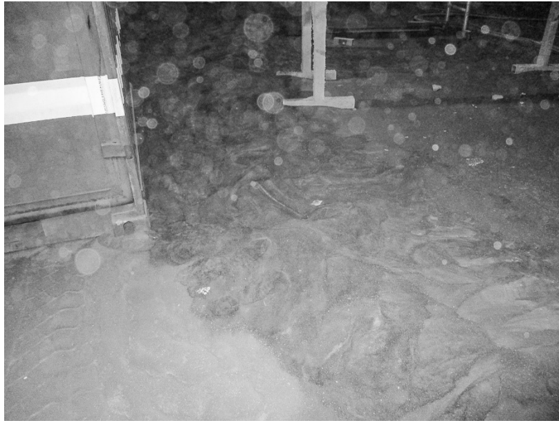
Meetlocatie 2A: Verontreiniging van de vloer van de straalcabine met gebruikt straalgrit
