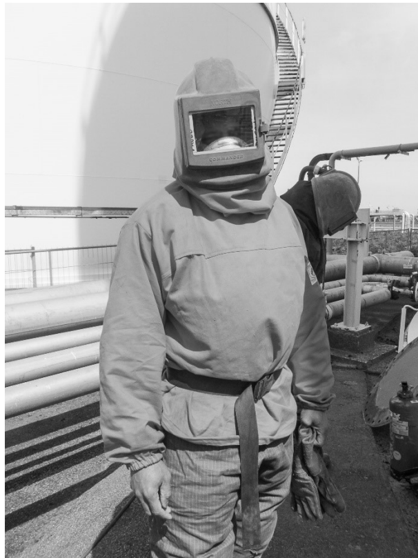
Meetlocatie 1C: Beschermende kleding, inclusief straalkap, zoals gedragen door straler tijdens straalwerkzaamheden
