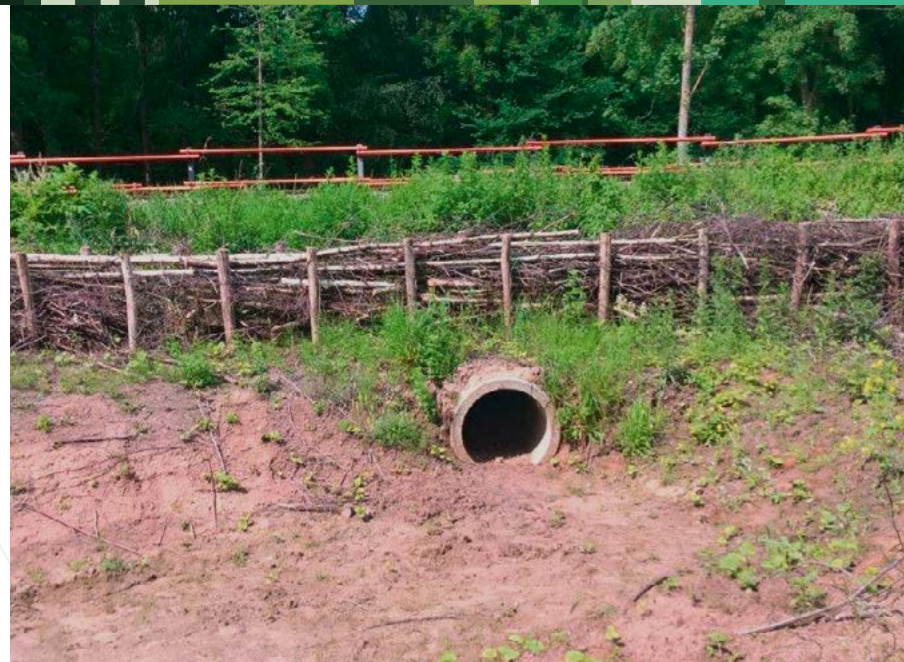
Kleine faunatunnel onder spoor bij Odiijk (UT6).
