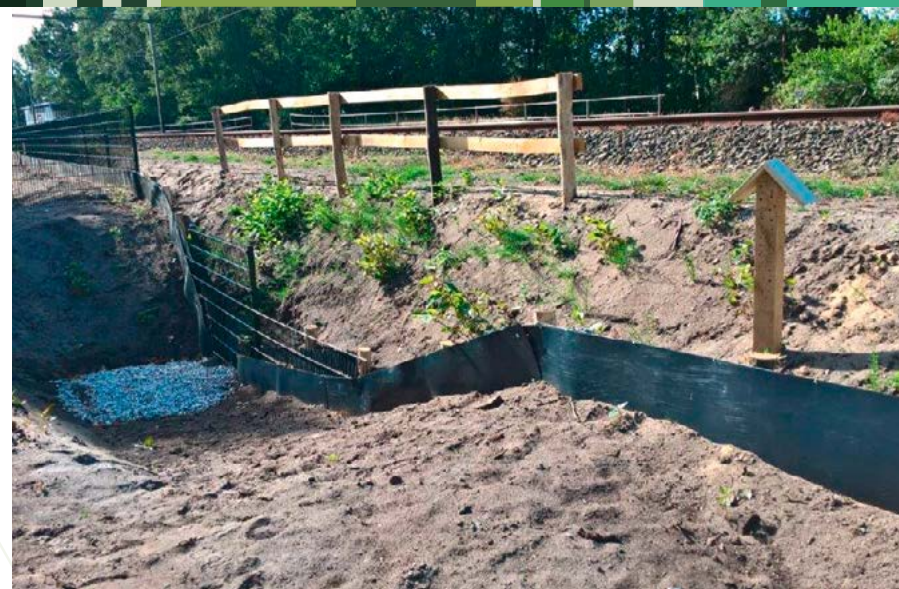
Voorbeelden van maatwerk kleine faunavoorzieningen bij Overberg (UT8).
