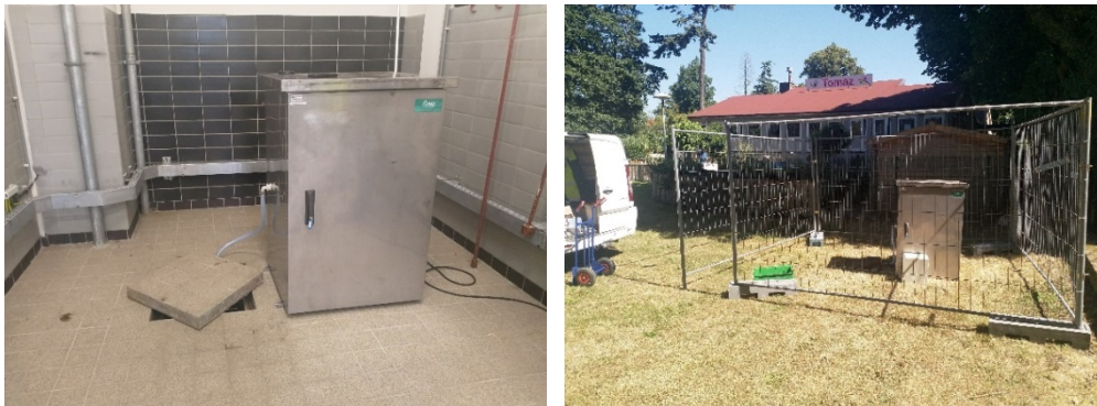
Figuur 8.1-1. De gebruikte vacuümkast bij gemaal Tuindorp (links) en bij de meetlocatie in Oog in Al (rechts).
