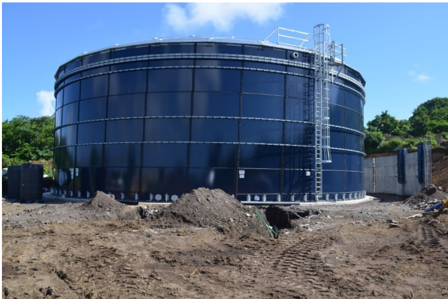
De nieuwe wateropslagtank met een capaciteit van 4000 m 3
