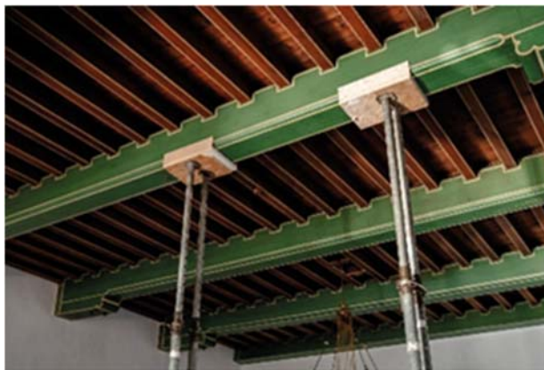
Weeskamer: ondersteuning van het plafond
