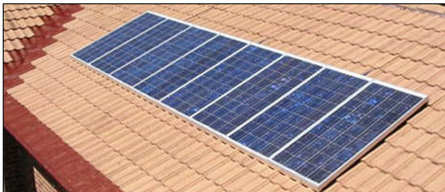
Afb. 16 PV-panelen met afmeting van ongeveer 1,55 x 0,80 meter (4,5 pan hoog, 4 pannen breed)
