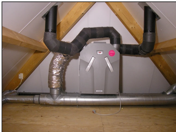
Afb. 14 Ventilatieunit voor mechanische toe- en afvoer van lucht (gebalanceerd ventilatiesysteem)
