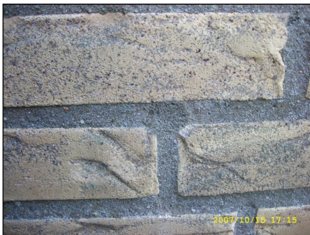
Afb. 3 Boorgat in de gevel
