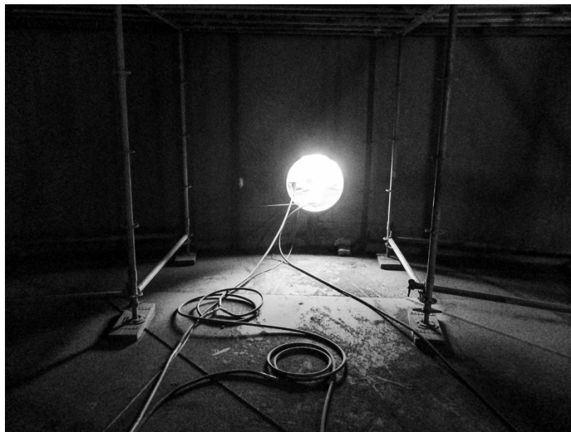
Meetlocatie 1C: Overzicht van binnenkant tank, inclusief aanwezigheid verontreinigd straalgrit op de vloer van de tank
