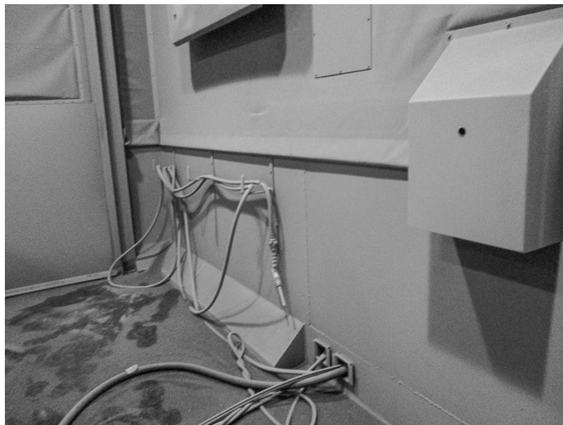
Meetlocatie 3: Binnenzijde straalcabine, aanvoer straalgrit (onder) en ventilatie-systeem (boven)
