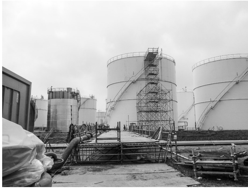
Meetlocatie 1C: Overzichtsfoto van omstandigheden tijdens afbreken steigermateriaal (5 weken na straalwerkzaamheden, vooraf is de tank schoongemaakt)
