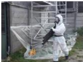
Foto: Golfplaat weglopen
