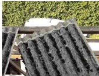
Foto: Gespijkerde golfplaat
