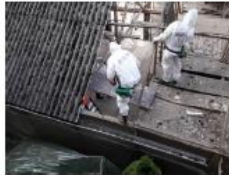
Foto: Golfplaat doorsteken
