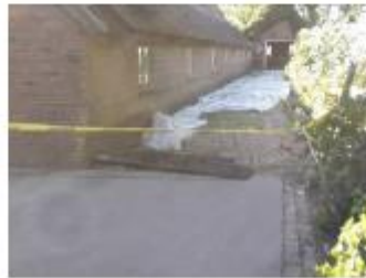
Foto: golfplaat op de grond gevallen
