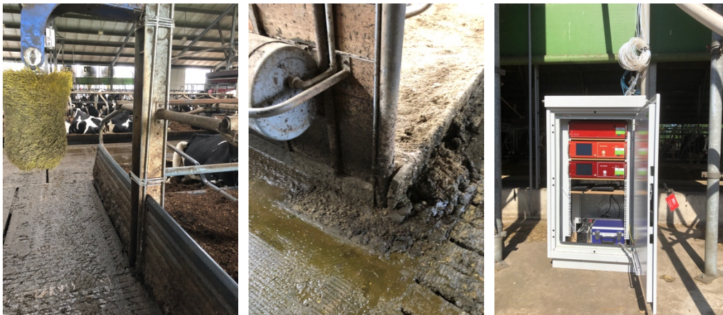
Afbeelding 2.1 De linker en de middelste foto laten een voorbeeld zien hoe de meetleidingen onder de vloer gaan. De rechtse foto laat een voorbeeld van de apparatuur zien, die buiten in een geïsoleerde kast staat.
