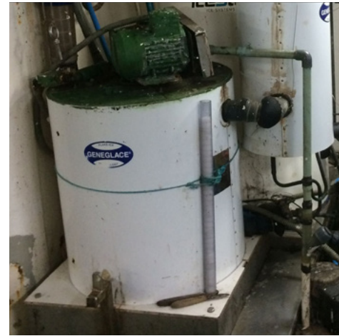
Figuur 29: Oorspronkelijke vriesinstallatie. (Bron: Maaskant Shipyards Stellendam)
