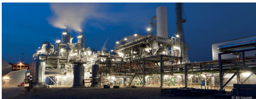
Afbeelding 3.2 SMR-installatie van Air Liquide
