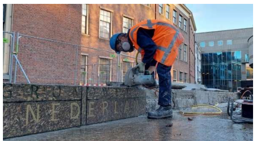
Loszagen van de grondwetbank, foto: RVB
