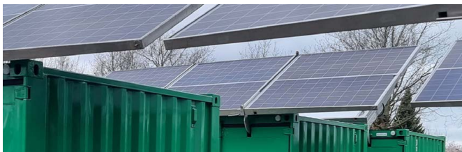
Zeecontainer als duurzaam energiesysteem
