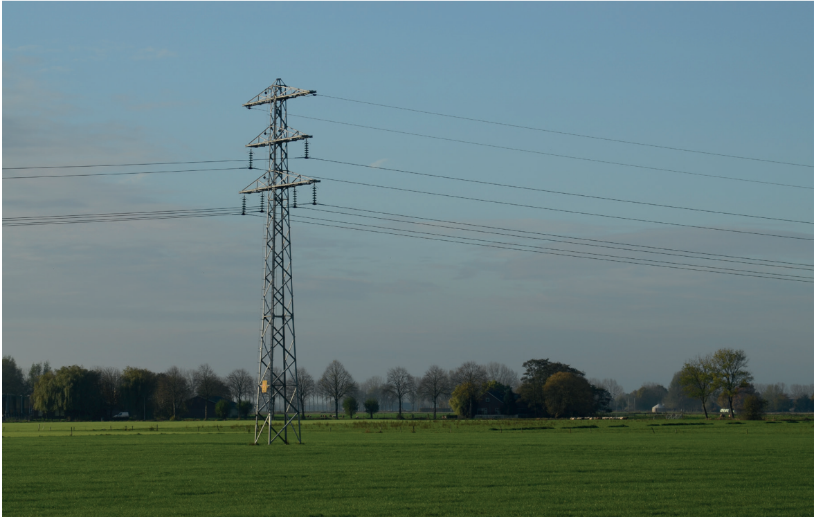
Figuur 10: Hoogspanningsleiding op de ongevalslocatie. Aan de linkerzijde van de mast zijn beide bliksemafleiders verwijderd nadat deze doorgesneden waren bij de draadaanvaring. (Bron: Onderzoeksraad voor Veiligheid)
