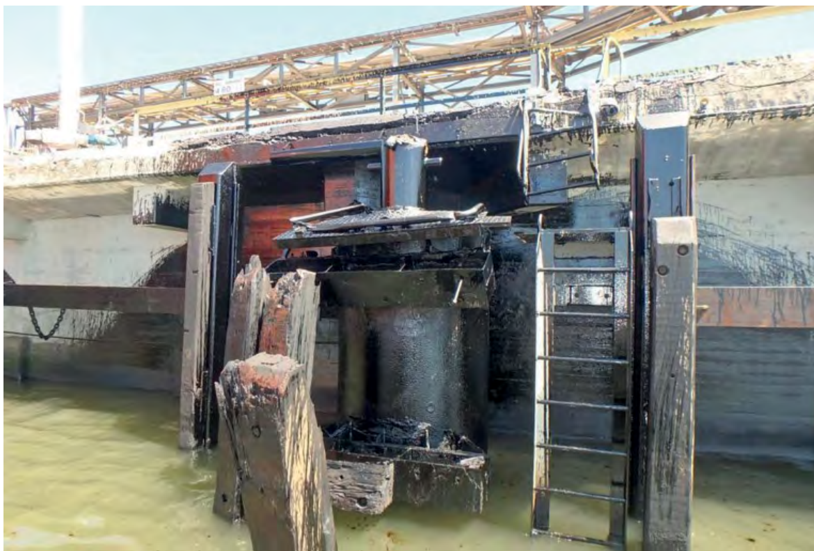
Figuur 10: De beschadigde trospaal 2. (Bron: Odfjell Ship Management AS)
