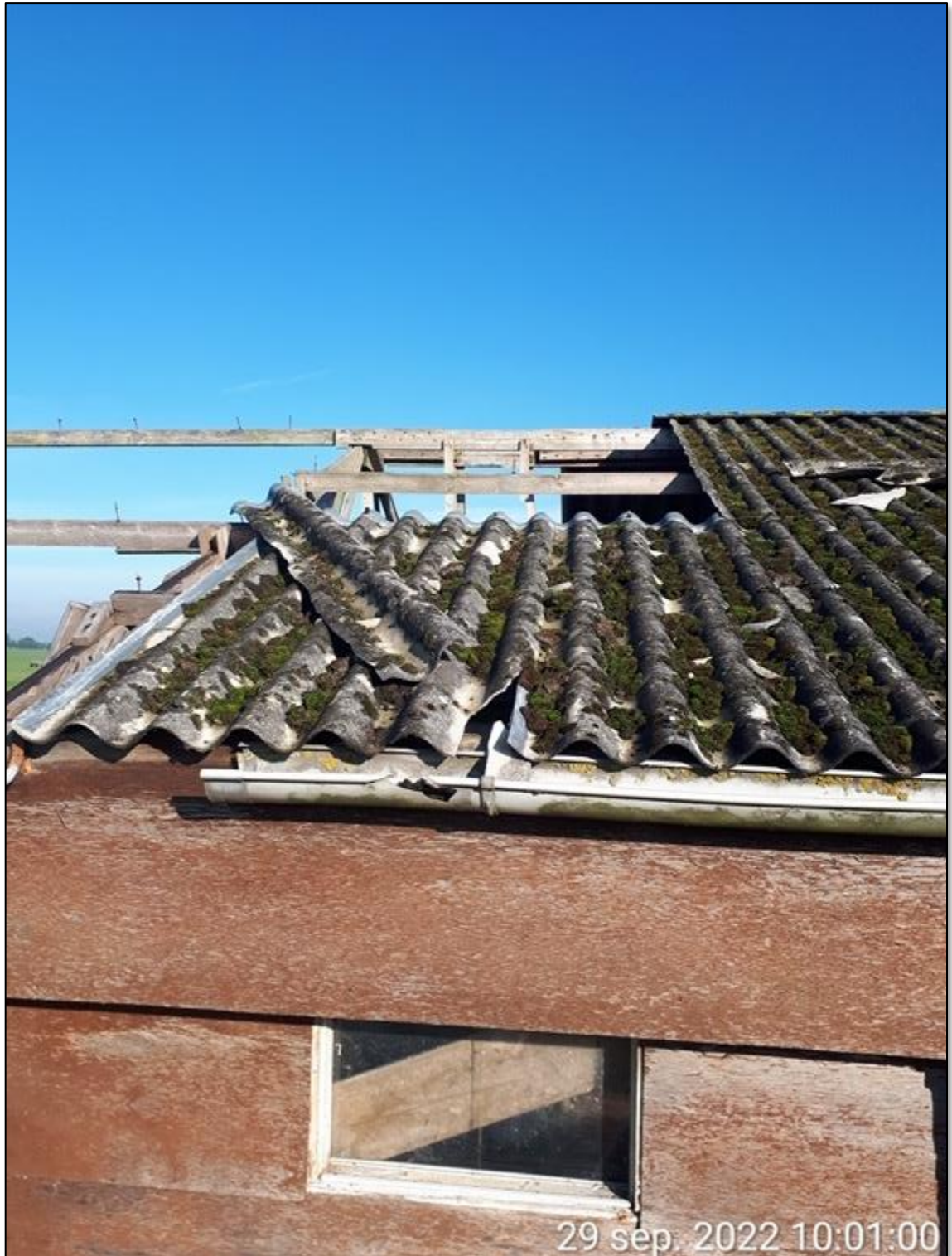
Foto: Beschadigd dak. Wind kan hier vat op krijgen en zorgen voor verdere beschadiging © Omgevingsdienst Regio Utrecht
