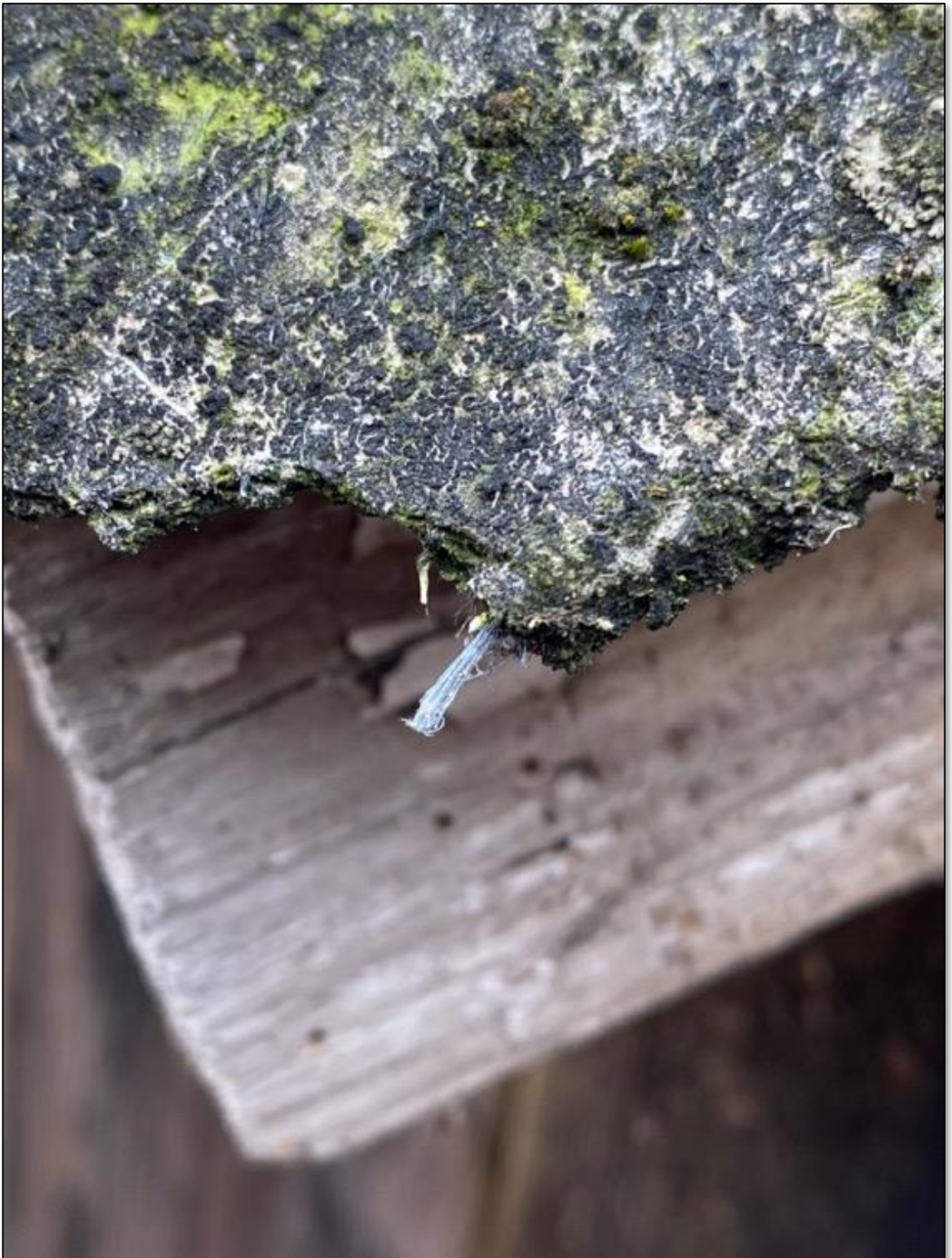
Foto: Asbestvezels steken uit een golfplaat © Waterman Legal Consultancy
