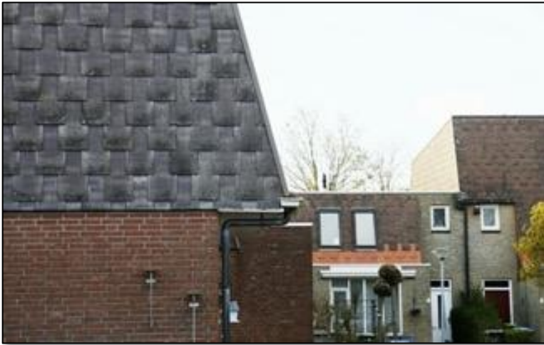
Foto: asbesthoudende leien in Lelystad
