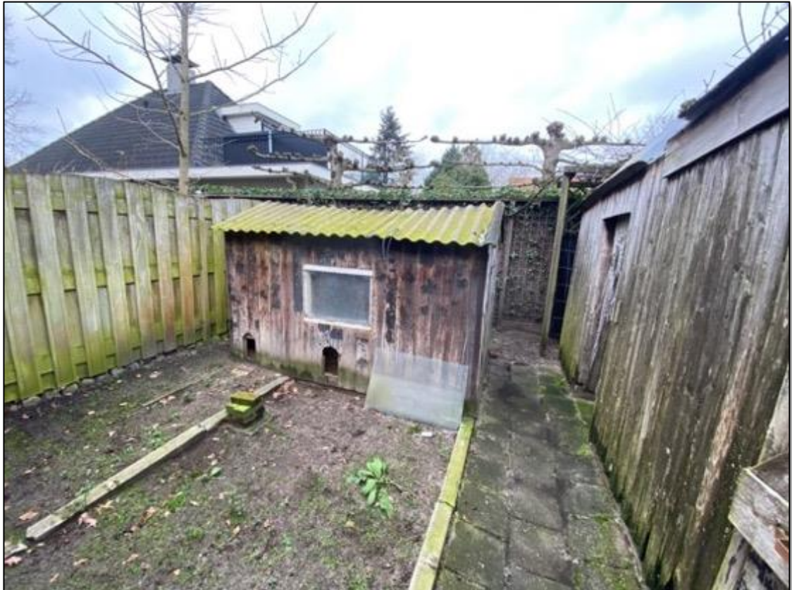
Foto: Schuurtje met een asbestdak in de achtertuin © Waterman Legal Consultancy
