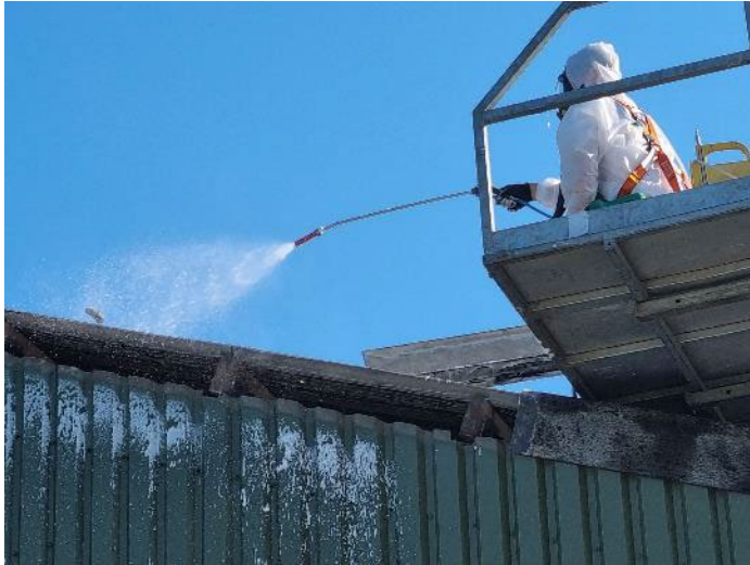
Foto 9: Bijschuimen terwijl nokstuk aan de zijkant in de bak van de verreiker wordt geplaatst
